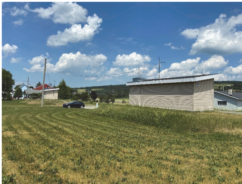
Photo 4 : Aperçu du bâtiment de production d'eau potable des puits PP-1 et PP-2 – 2020-06-22
